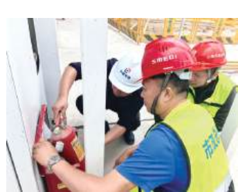
灭火器有效期检查
